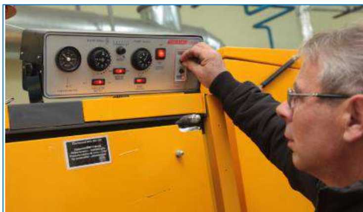
Figura 115: Lansarea unui sistem termic pe biomasă în raionul Ungheni cu sprijinul partenerilor internaționali de dezvoltare
